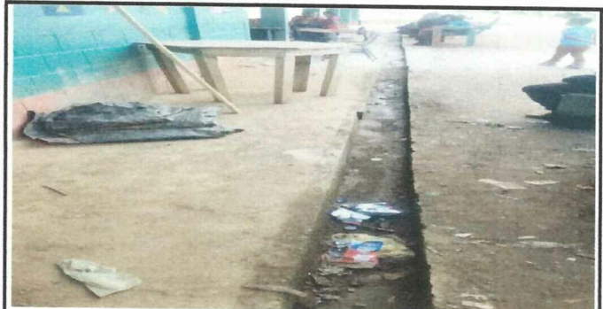
Foto 2: SE NECESITA LA COLOCACION DE REJILLAS DE METAL YA QUE ACUMULA MUCHA BASURA CUANDO LLUEVE
